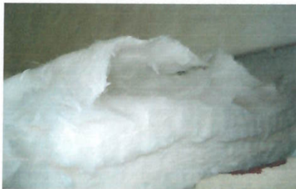
Figura 20 - Produto delaminando sem resistência.
